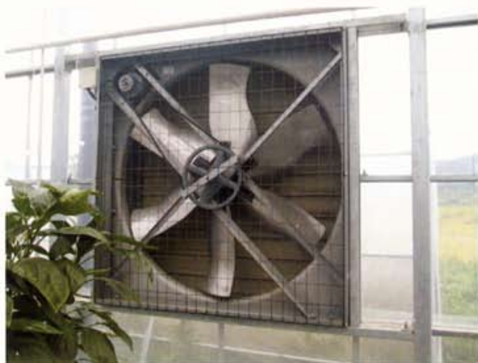
有圧換気扇装置
